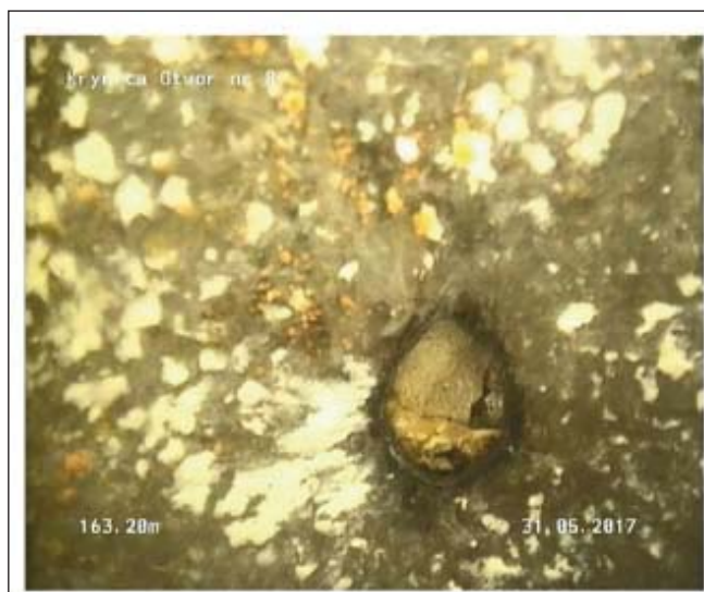
Fot. 1. Kadr z inspekcji TV – widok na otwór w obrębie rur okładzinowych na głęb. 163,2 m
